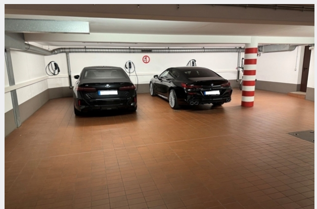
Tiefgarage mit 6 Wallboxen 22KW
